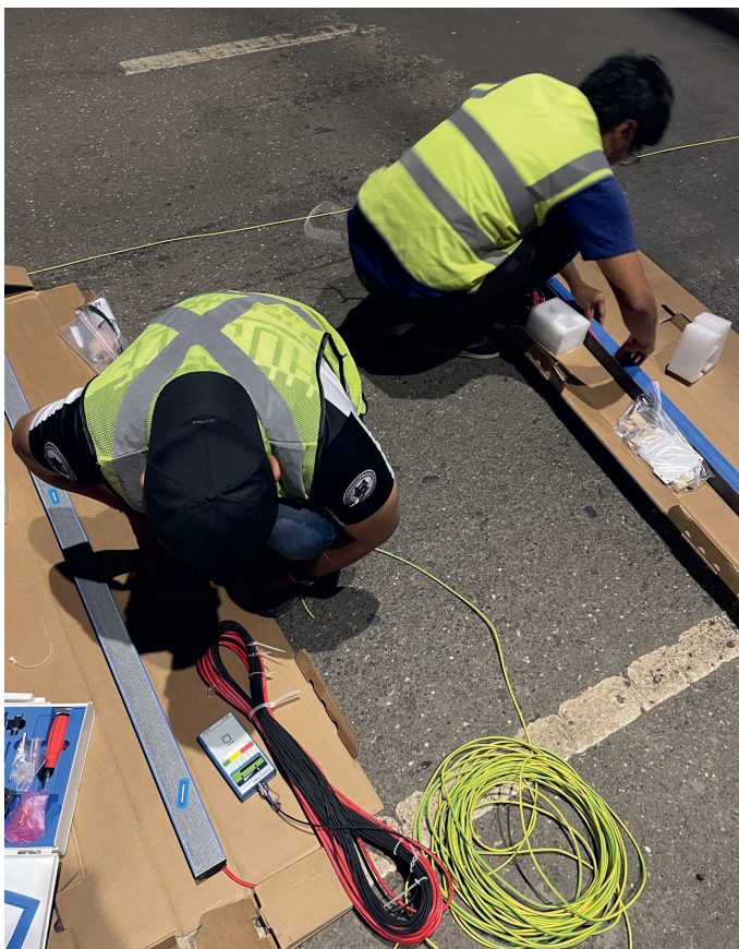
Die Lineas Sensoren von Kistler für die Weigh In Motion Installation zum Brückenschutz am CCLEX (Seite: Cebu City) werden vor dem Einbau überprüft.
