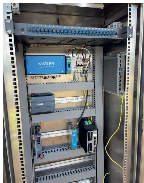
Alle Komponenten für Weigh In Motion von Kistler werden vorverdrahtet auf der Hutschiene geliefert – zum einfachen Einbau in den straßennahen Schaltschrank für CCLEX – und sind vernetzt mit dem Verkehrsmanagementsystem von Indra.
